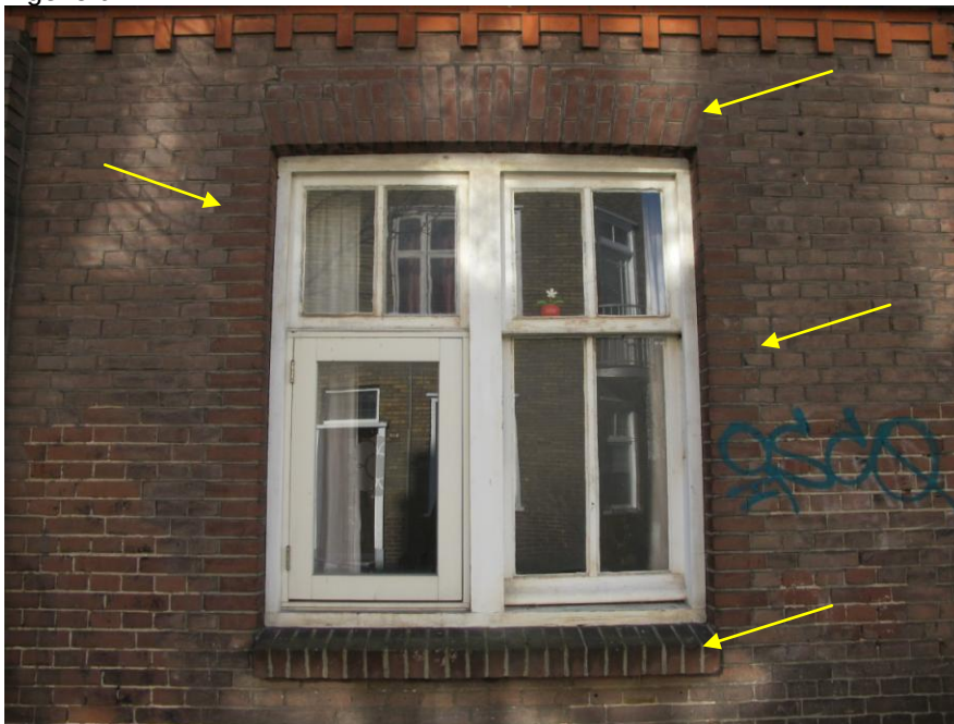
In de jaren '50 in de zijgevel van het vroeg 20 ste -eeuwse bouwdeel van de oostelijke zijbeuk ingebroken venster, herkenbaar aan de jongere baksteen in de dagkanten en strek, alsmede de in jongere baksteen uitgevoerde lekdoorpel. (gele pijlen)
